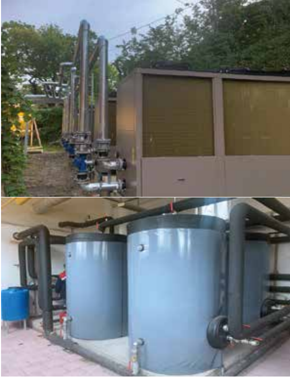
Neu installierte Luft-Wasser-Wärmepumpenanlage in Lviv Fotos: Lvivteploenergo
